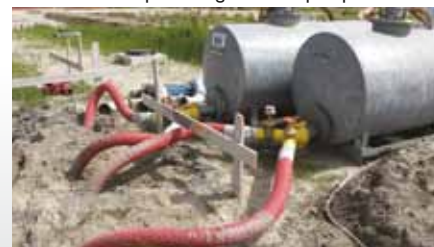
Tubazione cieca per collegamento a pompa
