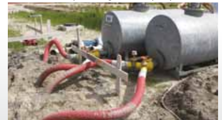
Tubazione cieca per collegamento a pompa
